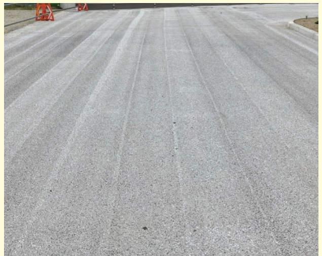
施工ムラ・ラップ筋
